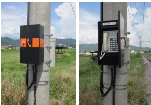
沿線電話機の更新と駅間増設
